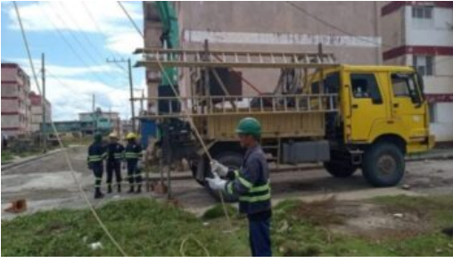
Att återställa elförsörjningen är prioriterat. Foto: Radio Guantanamo
